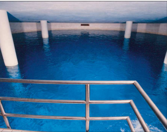
Ein Wasserbehälter des Wasserwerks Schlierbach
